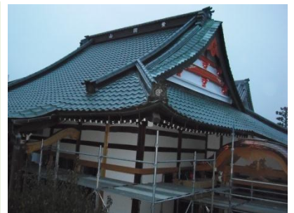
完成間近の様子。 大屋根の破風の化粧もされ とても綺麗になりました。
